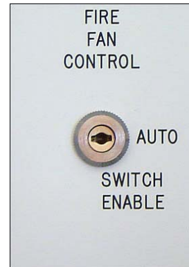
Fan Control Key-Switch
